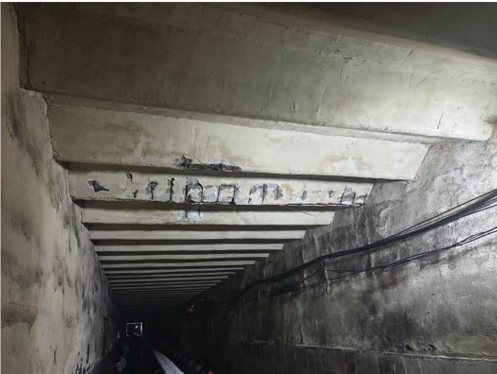
( 钢筋露筋现状 )
